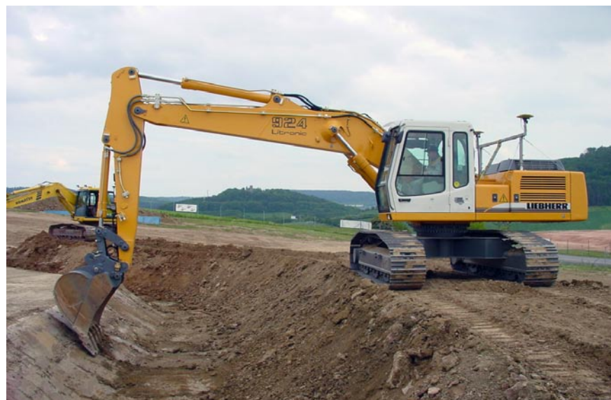
System Topcon 3DXi na koparkę pozwala realizować skarpy, nasypy, rowy, odwodnienia bezpośrednio z projektu cyfrowego
