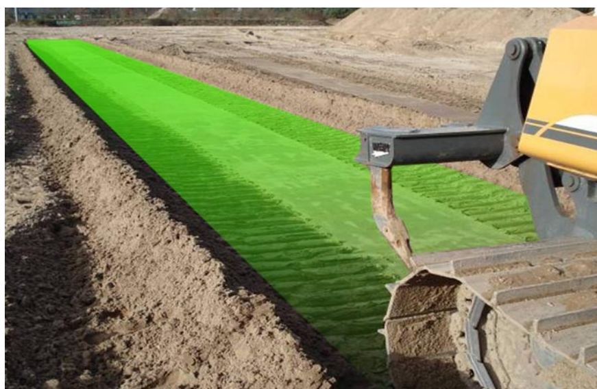
Wyposażona w system 3D MC 2 spycharka może pracować równie szybko i dokładnie na odcinkach prostych, jak i na łukach, nie występuje przy tym podbijanie lemiesz na zakrętach
